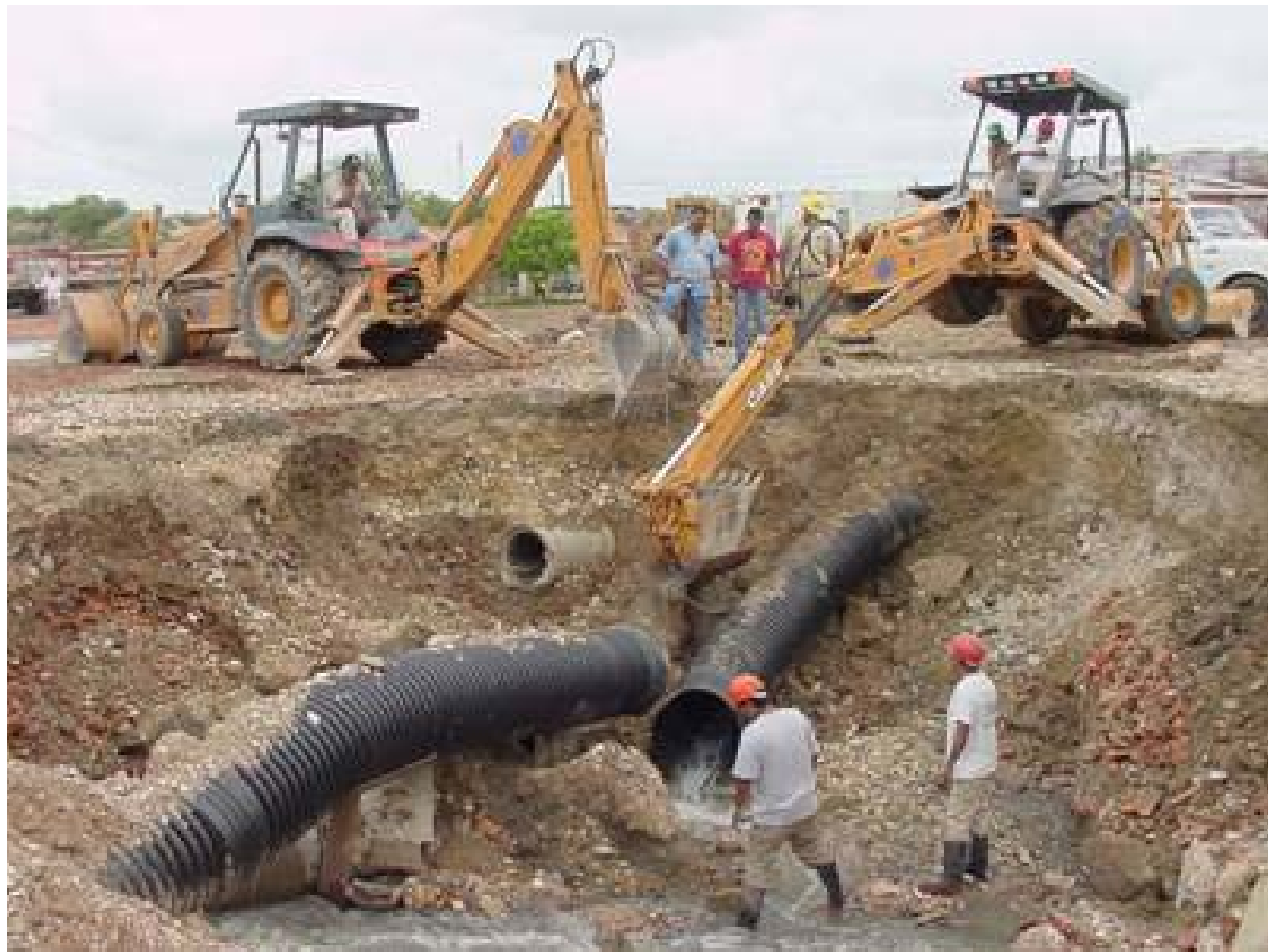
Afectación al Colector Salinas
